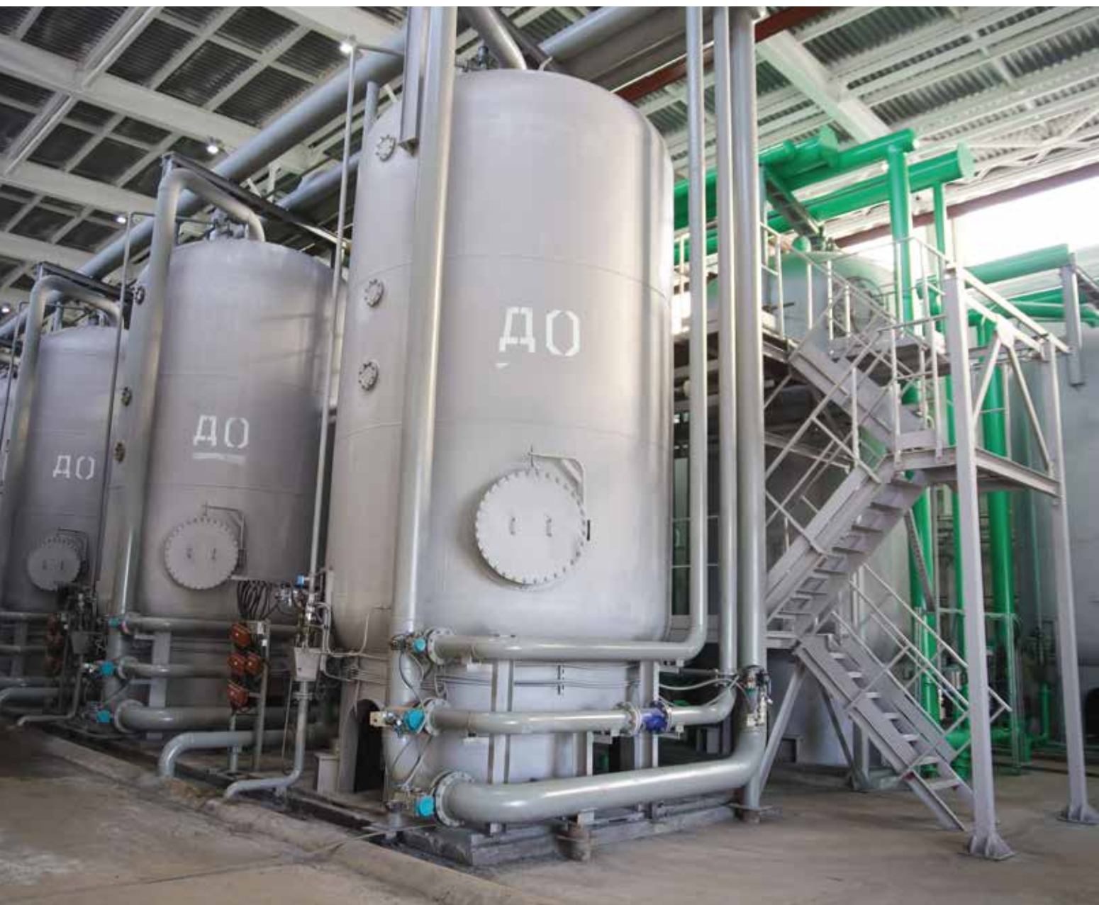
Система очистки шахтных вод шахты «Денисовская», Республика Саха (Якутия)
