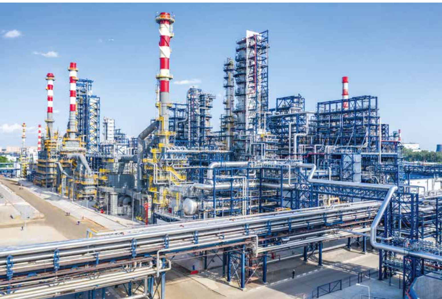
Комбинированная установка переработки нефти «Евро+» на Московском нефтеперерабатывающем заводе
