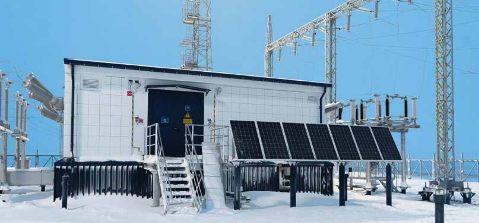
Цифровая подстанция «Север» на Новопортовском нефтегазоконденсатном месторождении, Ямало-Ненецкий автономный округ
